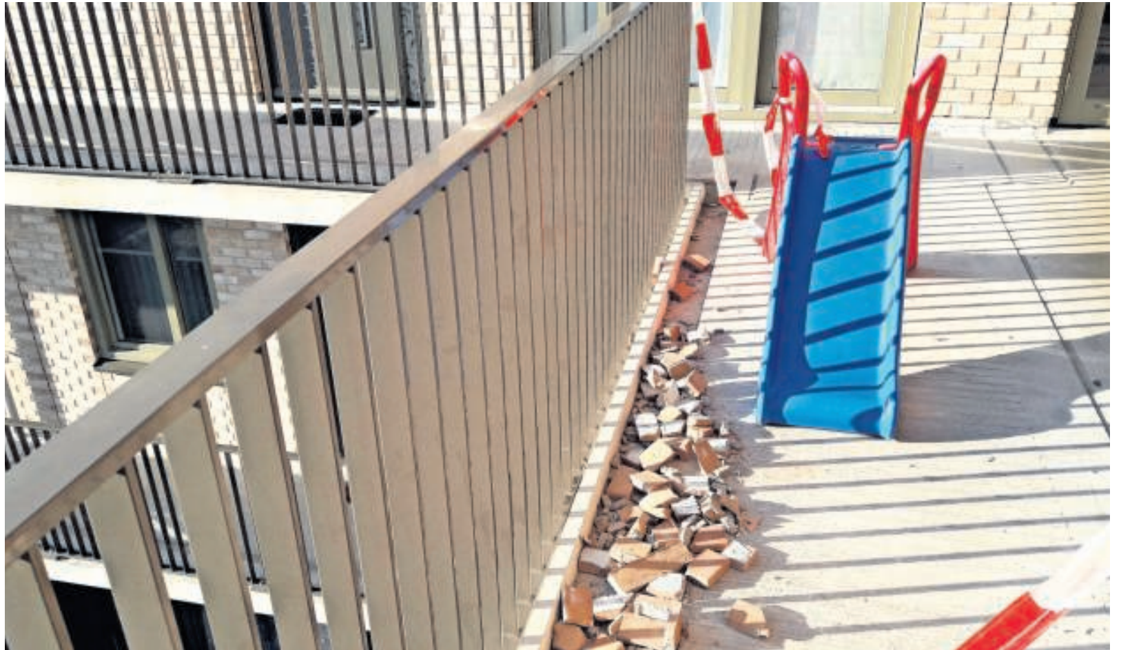
▲ November vorig jaar vielen er ook al stenen van de gevel, toen vielen ze net naast het glijbaantje op deze galerij. FOTO AD
